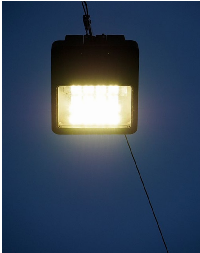
LED-Strassenlampe: Heller und sparsamer
