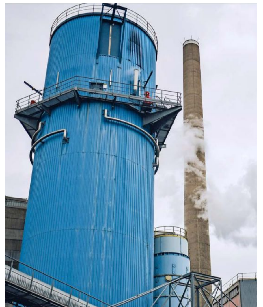
Im Extraktionsturm entsteht der zuckerhaltige Dünnsaft.
